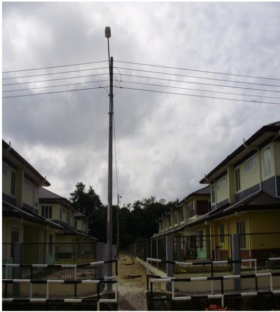
Kabel atas dikawasan kediaman dipasang selari dengan jalan laluan belakang dan di lorong-lorong kecil
